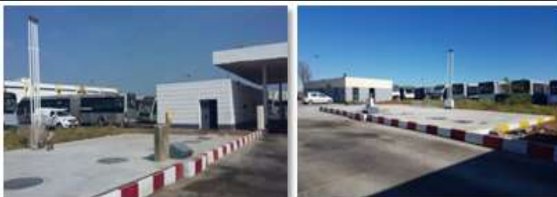
Figure 8: Le dallage de la zone autour des cuves, la réfection de la mise à la terre du véhicule et la surélévation de la bouche de dépotage
